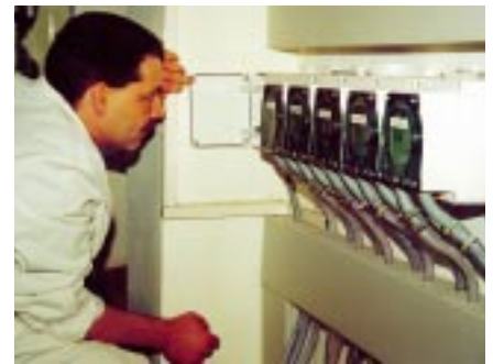
Kontrolle der installierten Flüssigdosierpumpen
